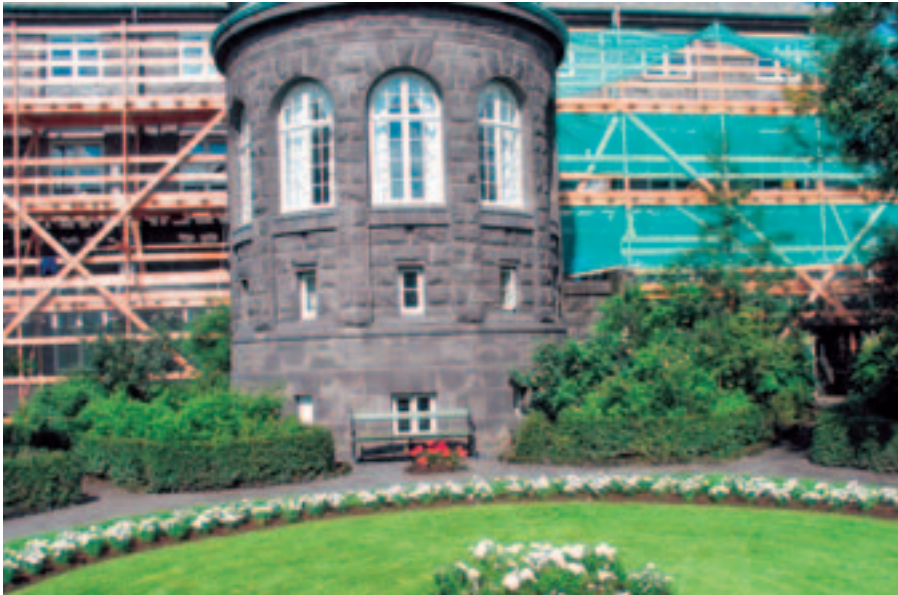
Í útveggjum Alþingishússins er grágrýti úr Skólavörðuholti. Sumarið 2003, 122 árum eftir að húsið var reist, hófst viðgerðir á suðurhlíð þess. Frekari lagfæringar á norður- og austurhlíðum eru fyrirhugaðar.
